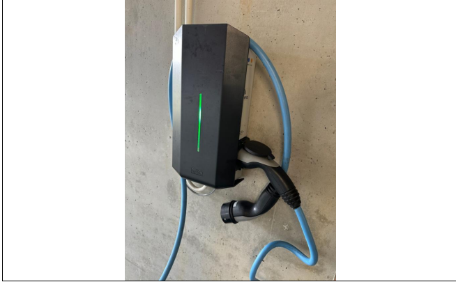
El-bil lader i felles garasjeanlegg.
