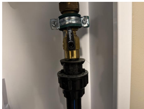
Stoppekran i rør i rør skap.
