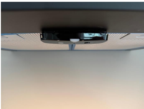
Komfyrvakt v/ kjøkkenventilator.
