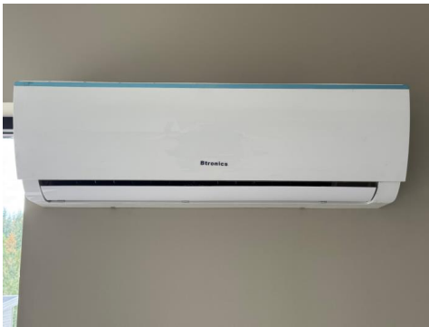
Varmepumpe med uttak i stue/kjøkken.
