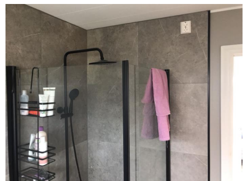
Bildet viser dør i våtsone.
