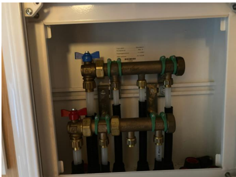
Fordeleskap for rør i rør (underskap i 2. etasje)
