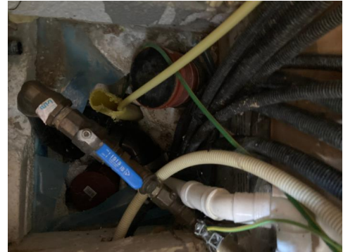
Vanninntak med stoppekrane
