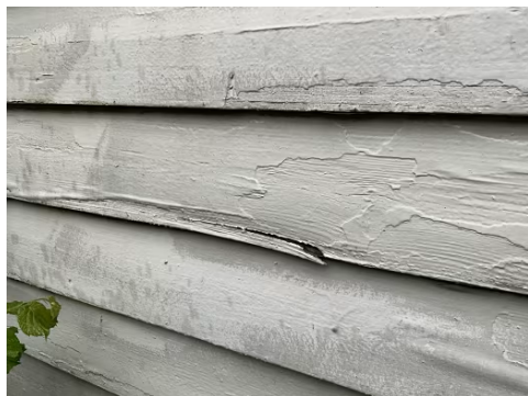
Råteskader og blæring.
