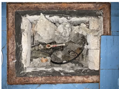
Stoppekran i luke i gulv i vaskerom.
