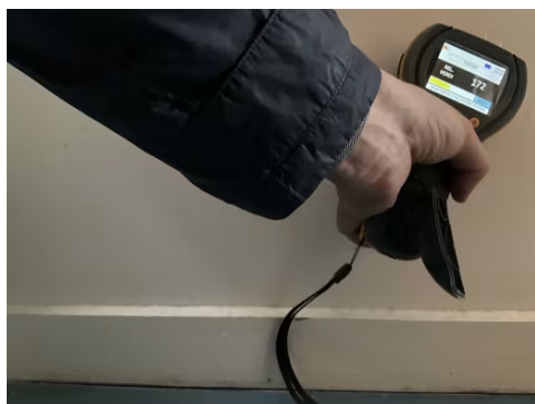
Måling på vegg i toalettrom.
