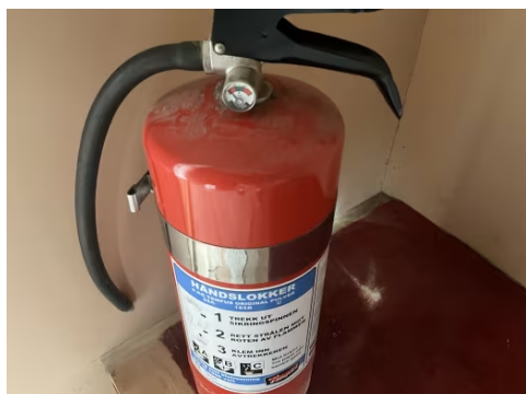
Slukkeapparat må byttes.
