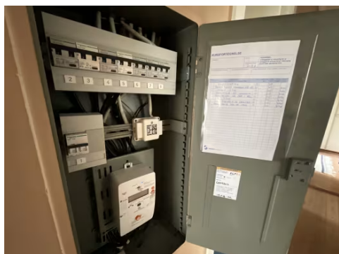
El-skap med automatsikringer.
