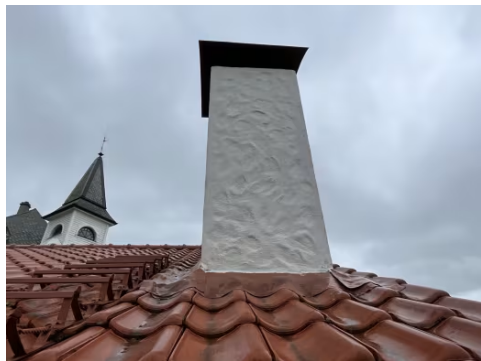
Pipe pusset og malt over tak
