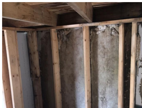
Bilde viser skade i bod
