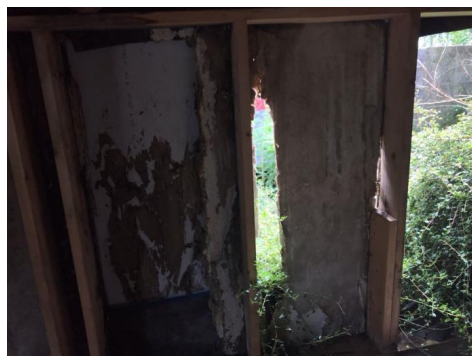
Bilde viser skade i bod
