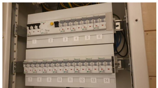
Sikringskap i bod med aut. sikringer.
