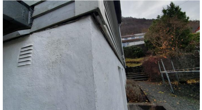
Lite luftesjikt mellom nederste kledningsbord og grunnmur.
