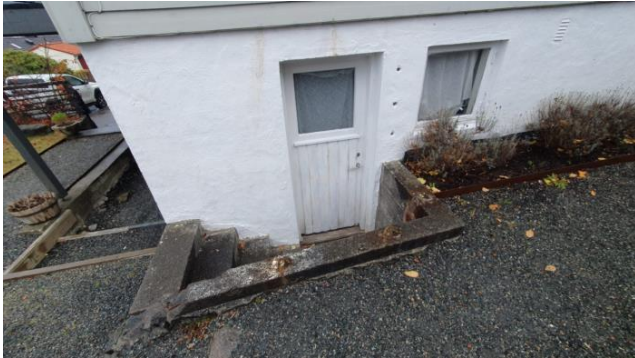
Det mangler sikring rundt trappeåpning til kjeller.
