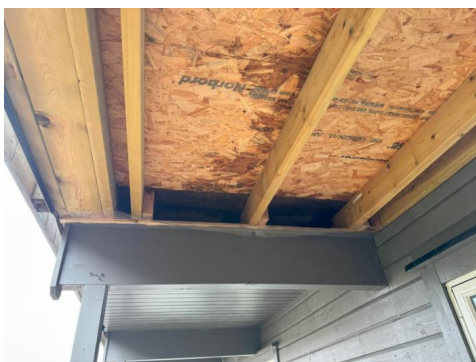
Bildet viser fukt i undergulv altan
