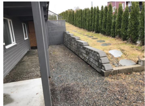
Bildet viser støttemur uten rekkverk.
