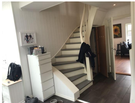
Bilde viser manglende rekkverk i trapp.
