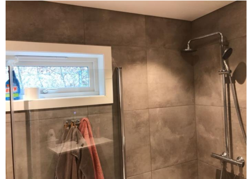
Bilde viser vindu i våtsone.
