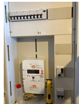
El-skap med automatsikringer
