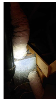
Mekanisk ventilasjon med aggregat på kaldtloft.
