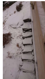
Naturstein trapp i sørøst fra kjelleretasje til terrassedekke mangler håndlist på vegger.
