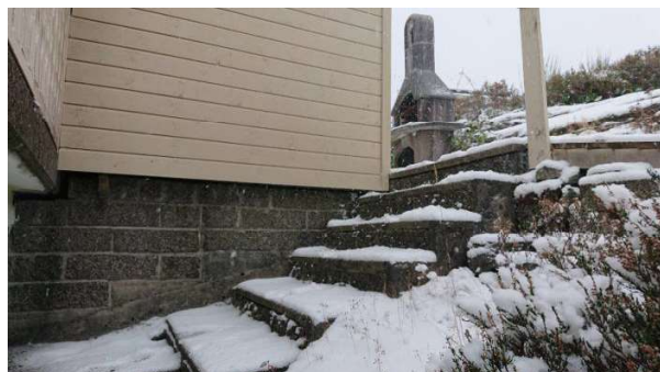
Håndlist eller rekkverk bør monteres.
