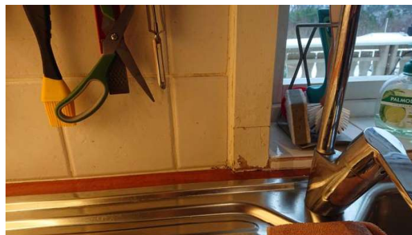
Fuktskadede listverk bak vask.
