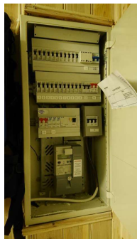
El.skap plassert i verkstedbod i kjeller.
