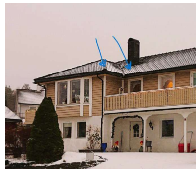
Merket område har synlig fuktskader i sutaksplater m.m. synlig fra kaldtloft.
