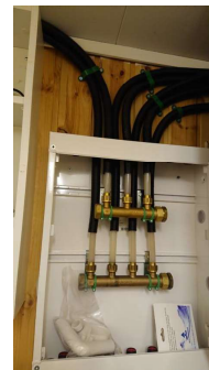
Rør-i-rør skap er plassert på vegg i sportsbod i kjeller.
