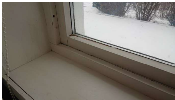
Flere vinduer har kondensskader i nedre kant av rammer.
