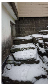
Håndlist eller rekkverk bør monteres.
