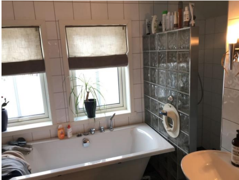
Bilde viser vindu i våtsonen.
