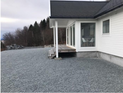
Bilde viser terrasse/altan uten rekkverk
