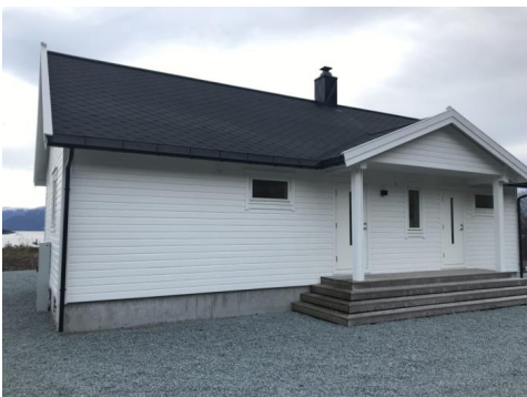
Bildet viser tak uten snøfangere
