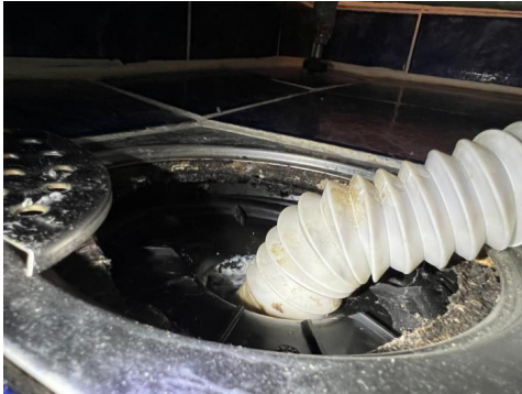
Sluk under dusjkabinett
