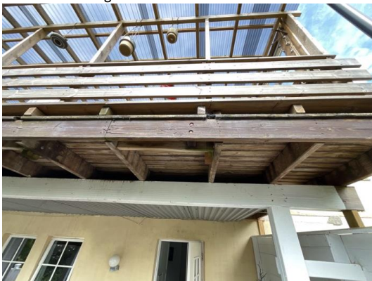
Slitasje på kledning på terrasse
