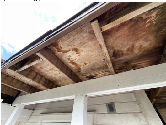
Fuktmerke rpå x-finerplater
