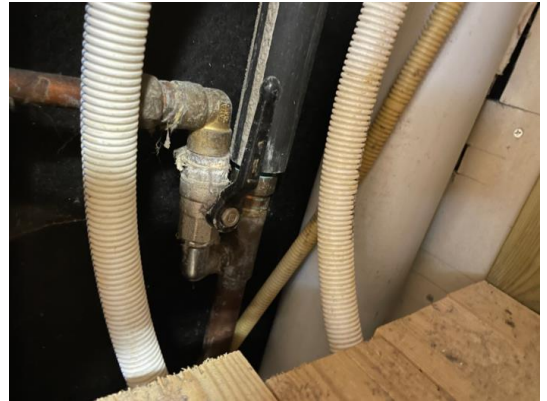
Stoppekran i kjeller
