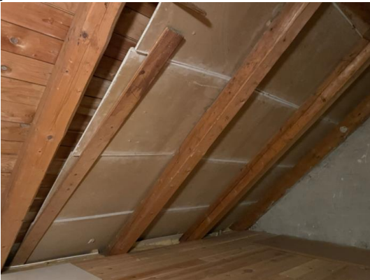
Gipsplater mot undertak
