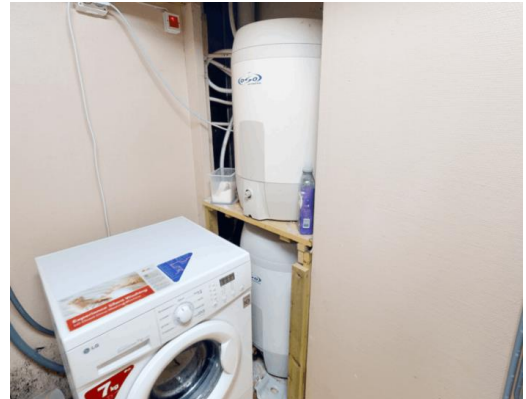
Varmtvannsberedere på vaskerom
