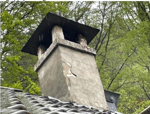
Utvendig avskalling på skorstein
