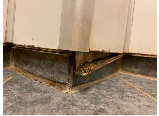
Fuktsvelling i nedre del av baderomsplater
