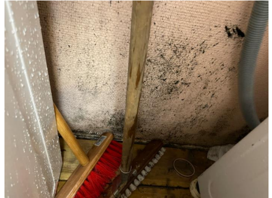
Fuktmerker på vegg pga. vann fra vaskemaskin
