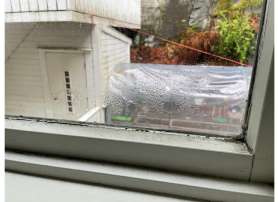
Innvendig kondensering (soverom 2 i 1. etasje)
