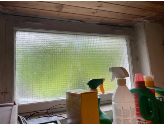
Sprekk i glass
