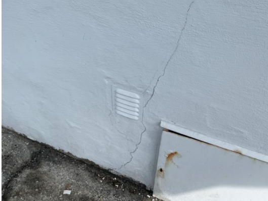
Noen sprekker i grunnmur
