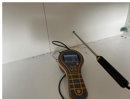
Kontroll med fuktprobe
