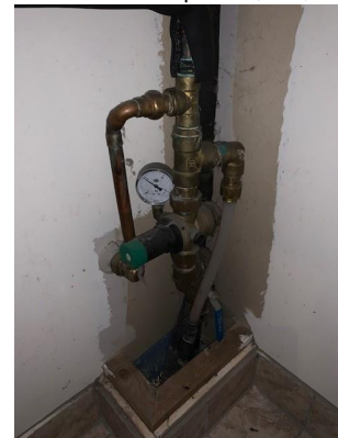
Vaskerom: Innvendig hovedstoppekran med bla. reduksjonsventil
