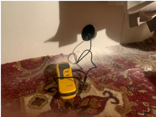
Bod: Bilde viser hulltaking og fuktmåler protimeter
