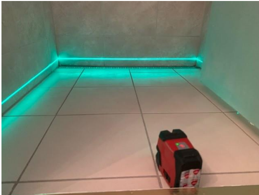
Bad: Dusjsonen med veggsluk. Bilde viser laservater
