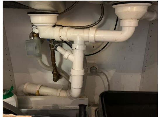
Kjøkken: Røropplegg under vask
