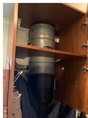
Vaskerom: Motor for sentralstøvsuger
