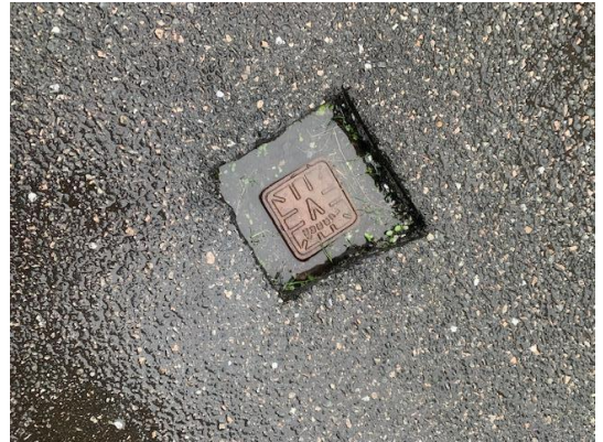
Utvendig hovedstoppekran i inngangspartiet
