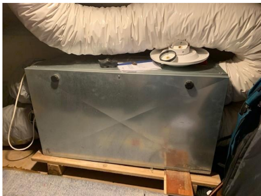
2. etasje: Bod/kott i knevegg med motor for Systemair villavent
