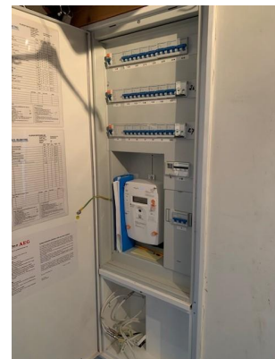
El-skap med automatsikringer, ny type måler
