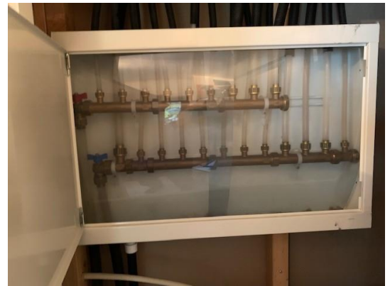
Vaskerom/teknisk-rom: Fordelerskap for "rør i rør" med overløp
