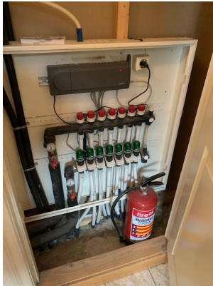
Fordelerskap for vannbåren varme
