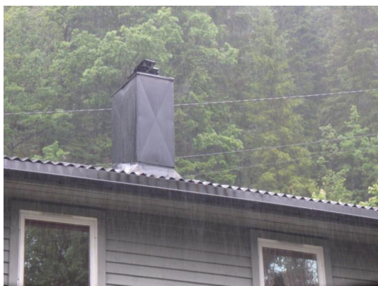
Pipe over tak
