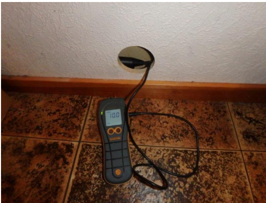
Fuktmåling fra hall med måleresultat på 10%
