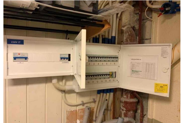
Sikringsskap i underetasje.
