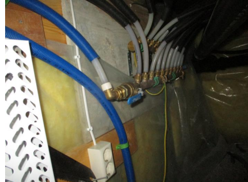
Greinrør for fordeling av vatn (rør i rør)
