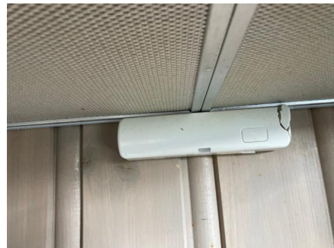
Skade på komfyrvakt
